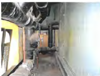
Climatizador Ala Este deteriorado
