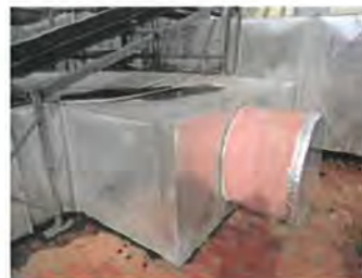
Conductos de retorno Ala Este sin conectar
